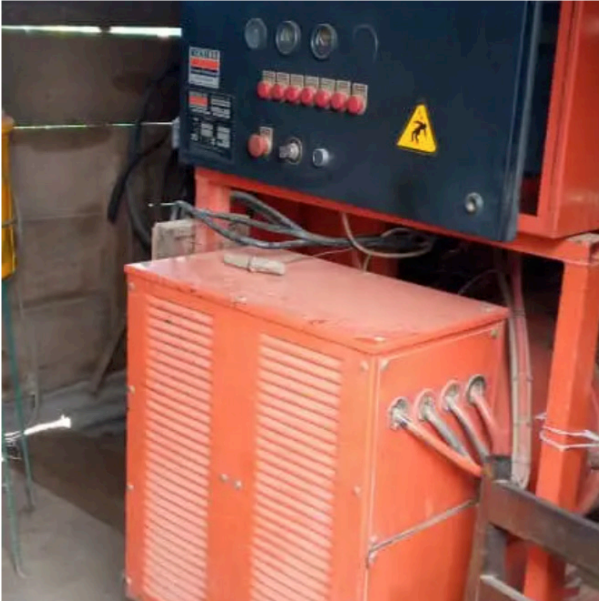
Generator at the Bouar office of the Agence pour la sécurité de la navigation aérienne (ASECNA). Photo by Emmanuel Singa, 30 July 2024.
